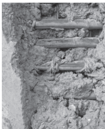
竹小舞の施工の様子と、築約100年の建物の土壁の剝離部分
